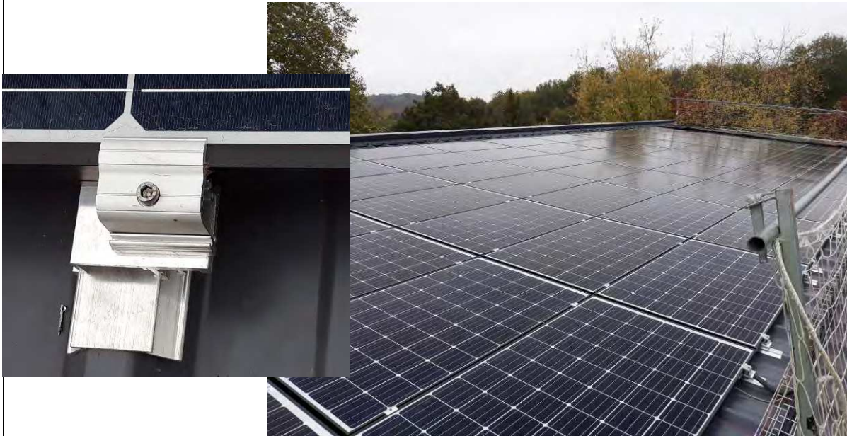
La centrale solaire en images
