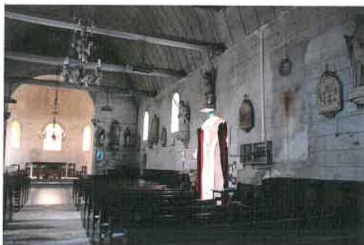
Nef nécessitant d'importants travaux de restauration et de mise en valeur
