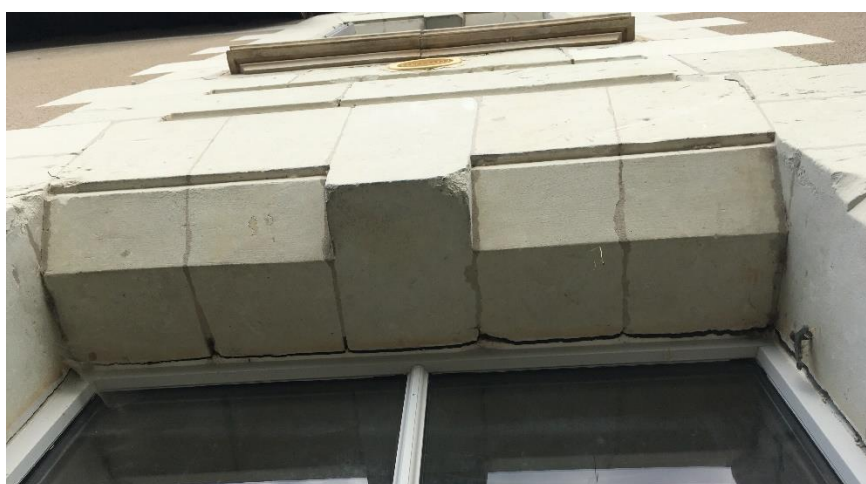
Photographie 24 : Façade nord. Fissures jonction menuiserie/maçonnerie.
