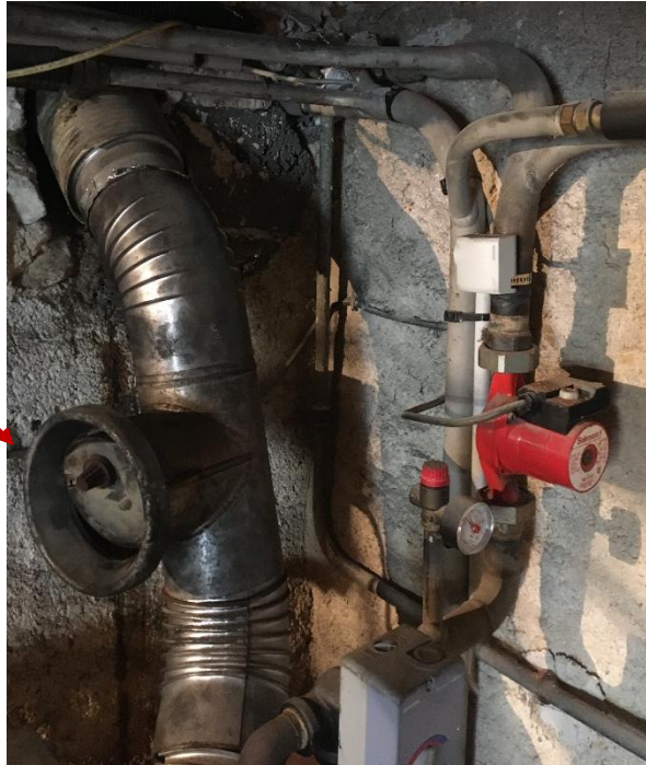
Photographie 34 : Conduit de fumée avec modérateur dont le clapet est bloqué et entrouvert.
