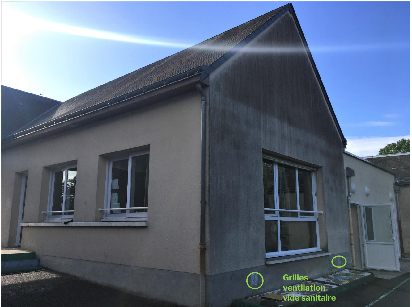
Photographie 1 : Pignon Sud. Enduit ciment sur l'ensemble des murs en parpaing. Ciment en partie basse fissuré. Traces noires en forme de parpaing indiquant une absence ou faible isolation des murs. Le triangle sombre laisse à supposer que les combles perdus sont isolés (probablement faiblement).
