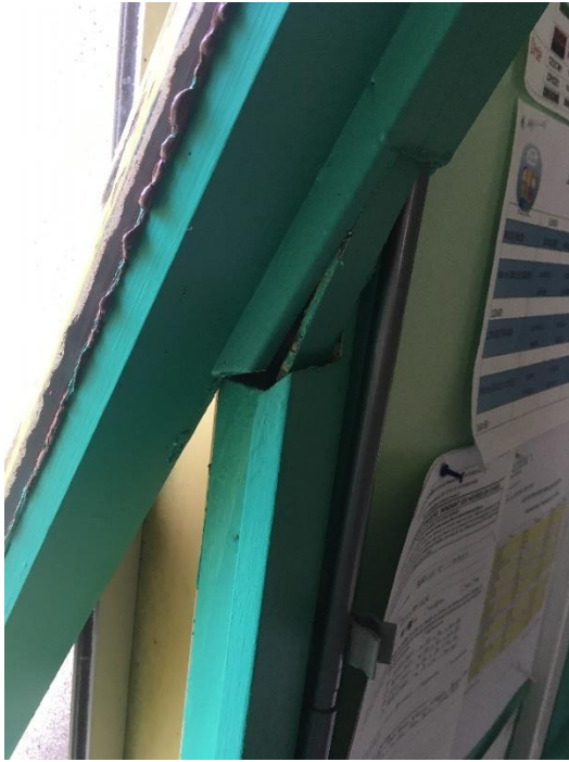
Photographie 16 : Mur sud. Fenêtre oscillante avec coulure du joint.
