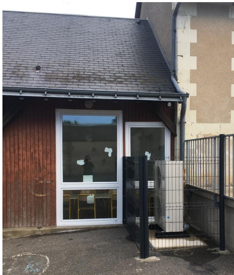
Photographie 20 : Façade sud. Fenêtres double vitrage récent en PVC. Modules extérieurs pompe à chaleur air/air (PAC a/a).
