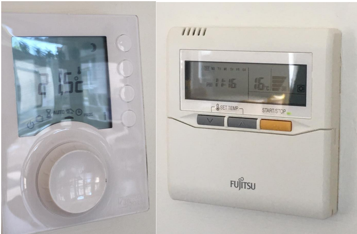
Photographies 21 et 22 : Boîtiers de régulation.
