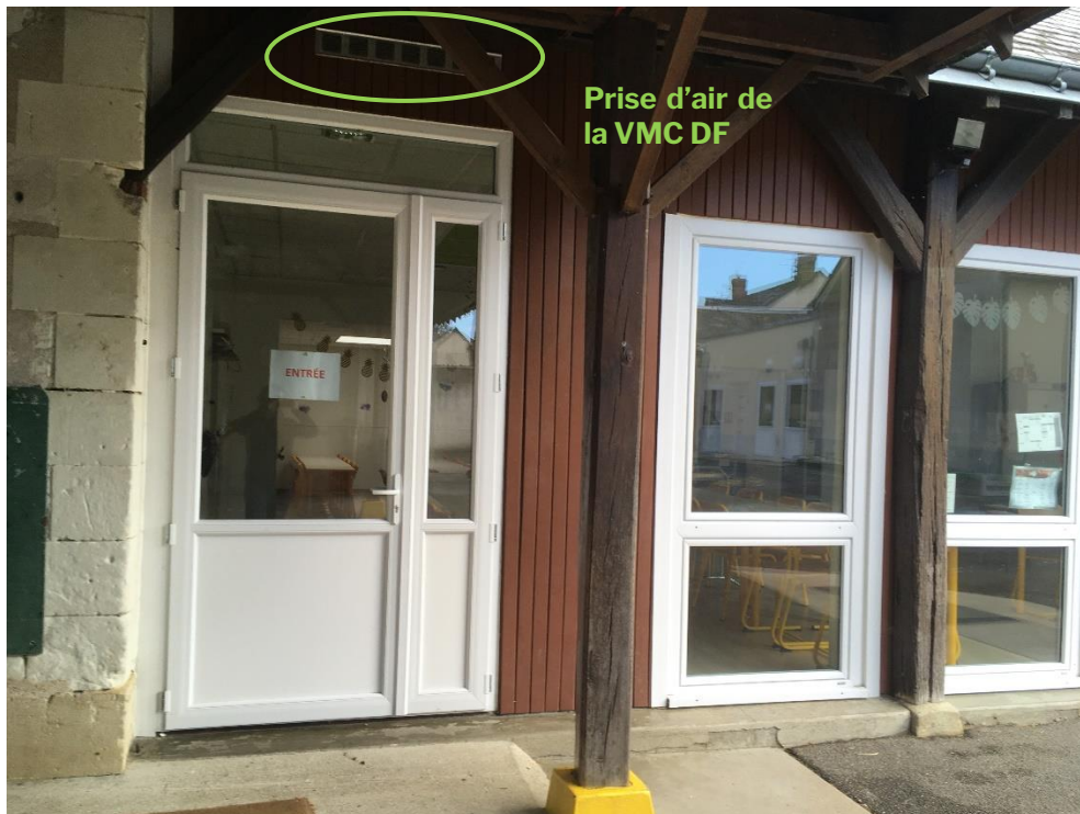
Photographie 20 : Façade sud. Fenêtres et porte-fenêtre double vitrage récent en PVC. Prise d'air de la VMC double flux.
