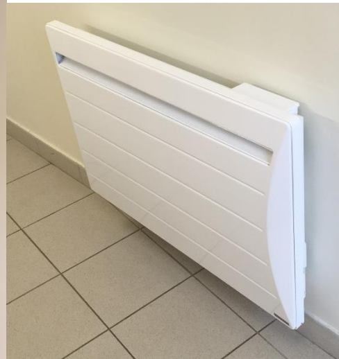
Photographie 12 : Radiant électrique avec thermostat programmable individuel
