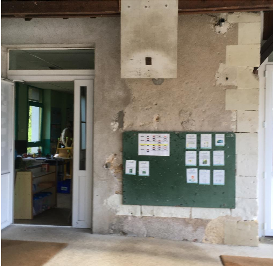
Photographie 13 : Façade est. Mur moellon avec différents enduits ciment. Pierre et mur dégradé.
