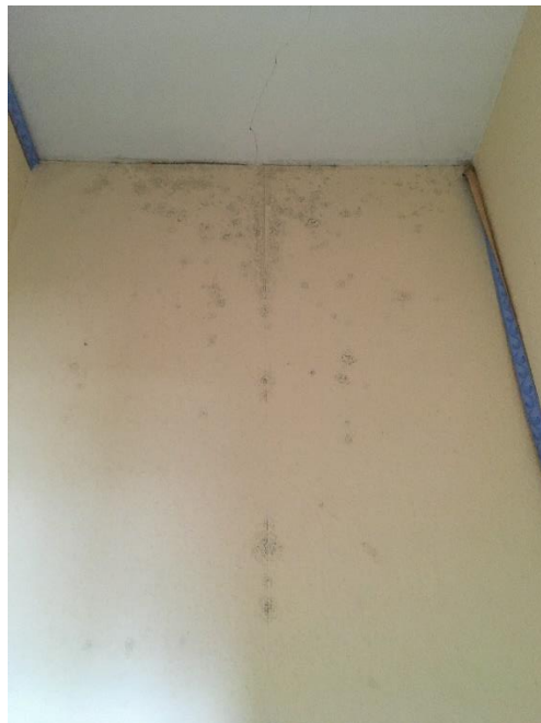
Photographie 29 : Sanitaire à l'étage. Fissures et traces d'humidité.
