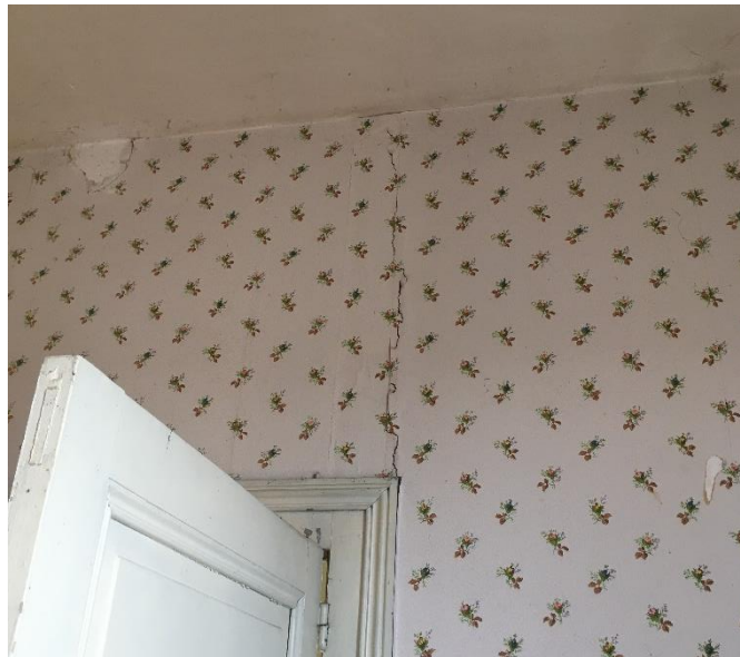
Photographie 30 : Salle à l'étage. Fissure.
