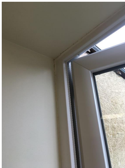
Photographie 10 : Façade sud. Fissures à la jonction menuiserie/maçonnerie.
