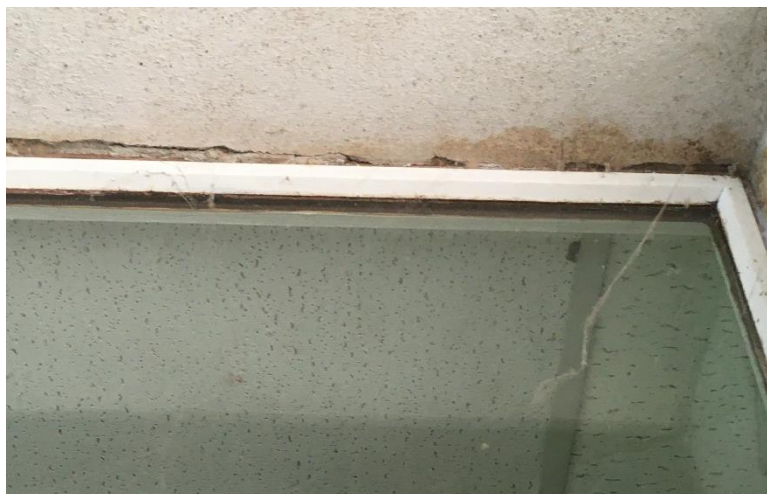
Photographie 14 : Façade est. Partie supérieure de la porte-fenêtre en double vitrage ancien bois. Fissures à la jonction menuiserie/maçonnerie. Enduit ciment.
