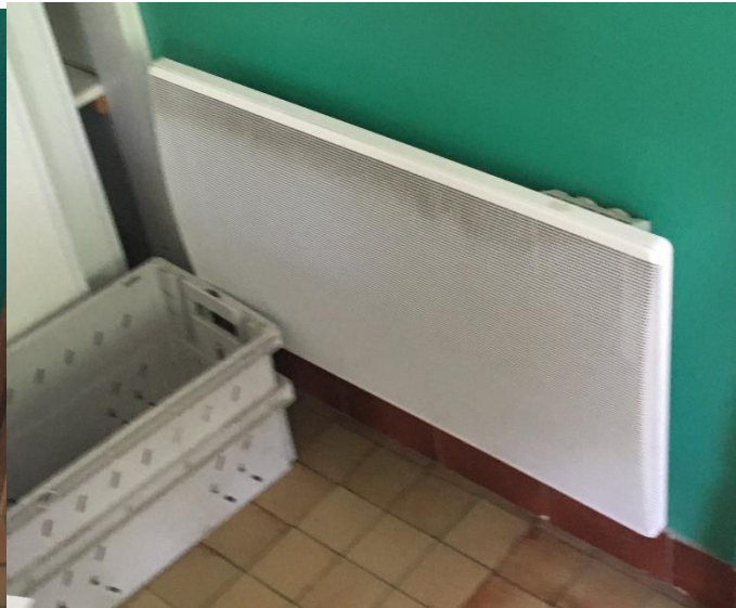
Photographie 19 : Radiant électrique ancien. Thermostat programmable individuel.
