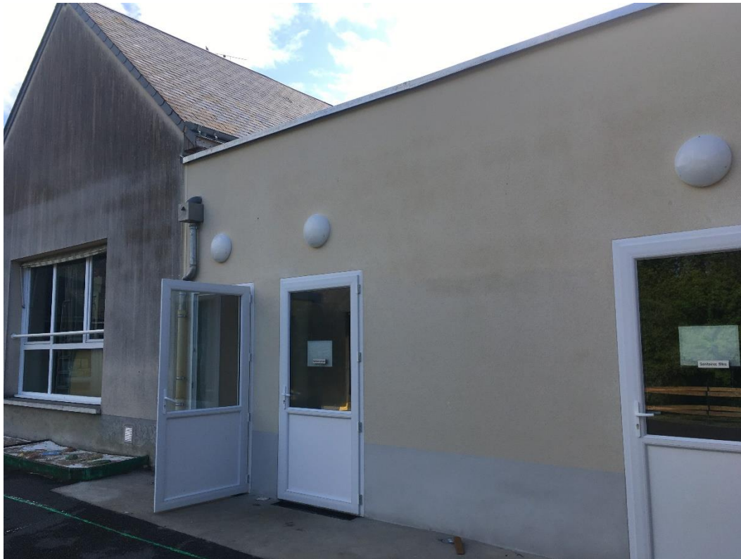
Photographie 9 : Façade sud. Eclairage LED extérieur. Portes-fenêtres sans entrée d'air. Traces noires en forme de parpaing indiquant soit absence ou faible isolation des murs, soit pose de l'enduit extérieur lors d'intempéries/temps humide.
