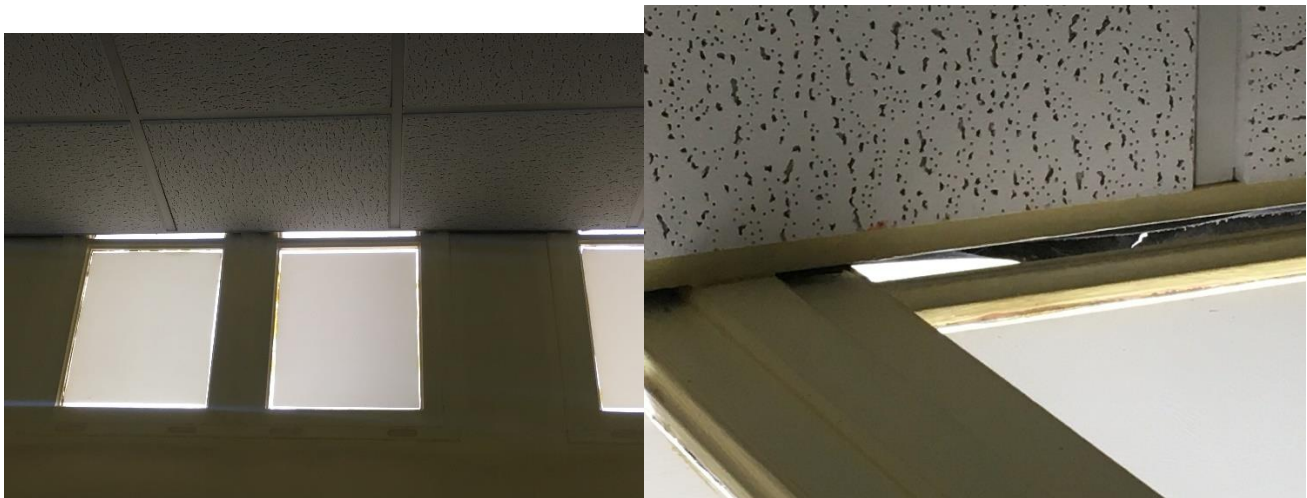
Photographies 26 et 27 : Mur ouest. Fenêtres obstruées par faux plafonds. Si le faux plafond est isolé, alors il y a des ponts thermiques.
