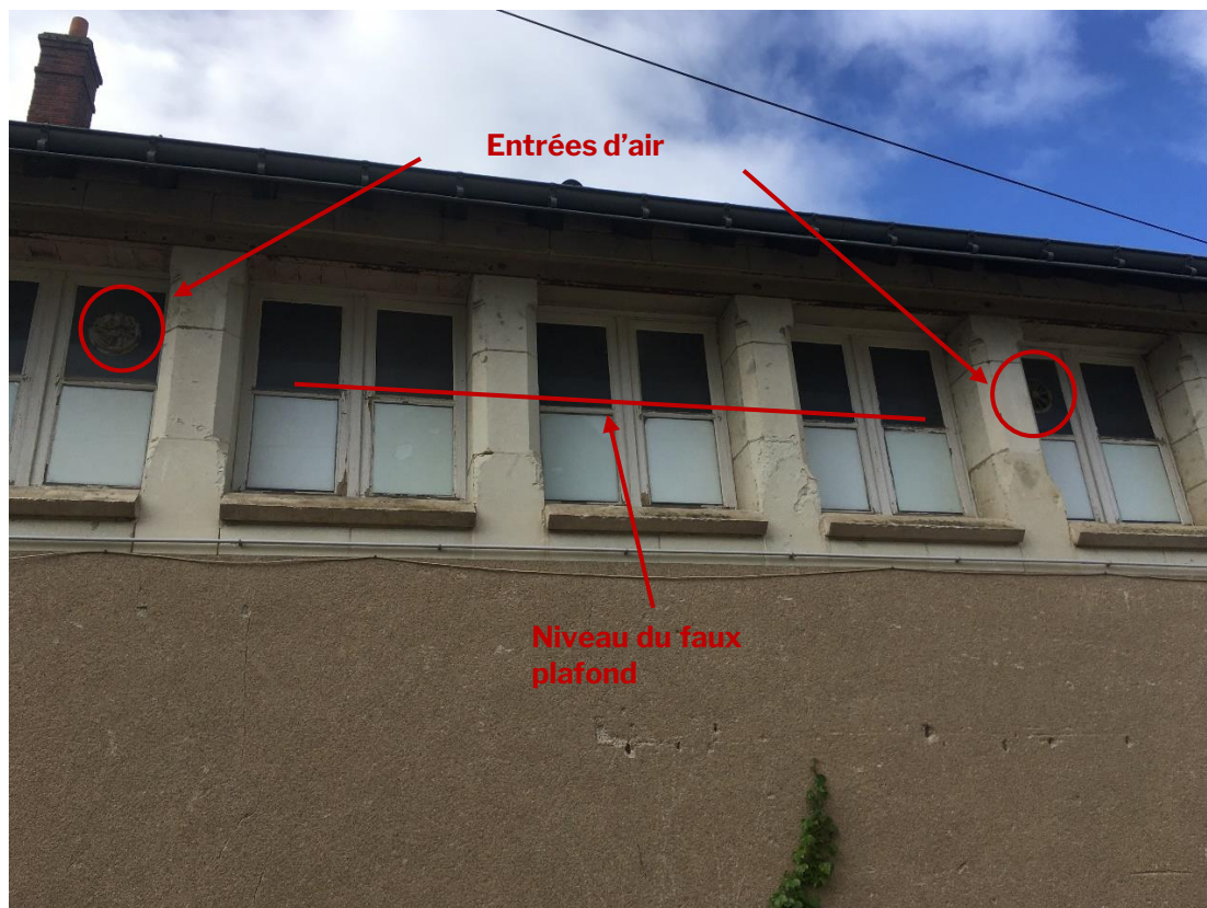
Photographie 31 : Façade ouest. Pierres et mur dégradés. Fenêtres obstruées à mi-hauteur par faux-plafond. Entrées d'air sur fenêtres donnant au-dessus du faux plafond.
