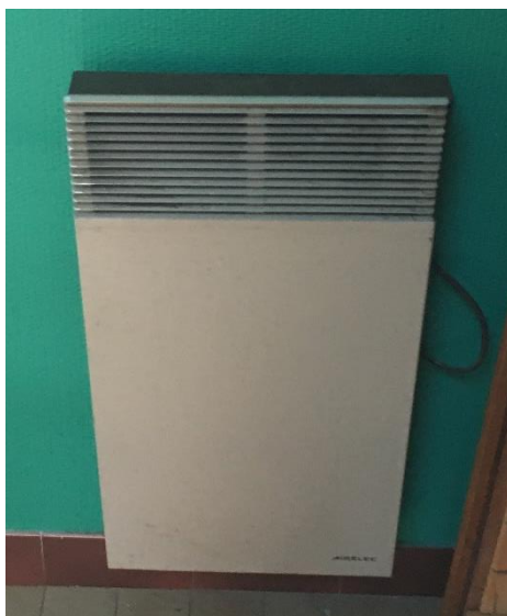
Photographie 18 : Convecteur électrique ancien. Thermostat programmable Individuel.
