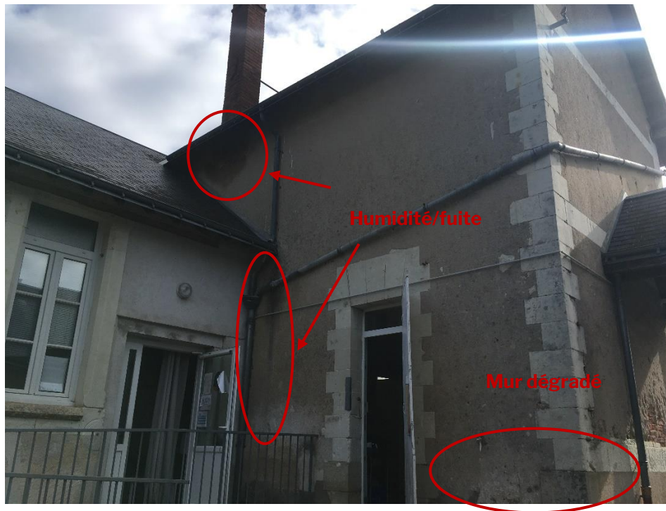
Photographie 25 : Mur en moellon. Fissures au niveau des pierres de parement. Trace d'humidité/fuite sur les murs.
