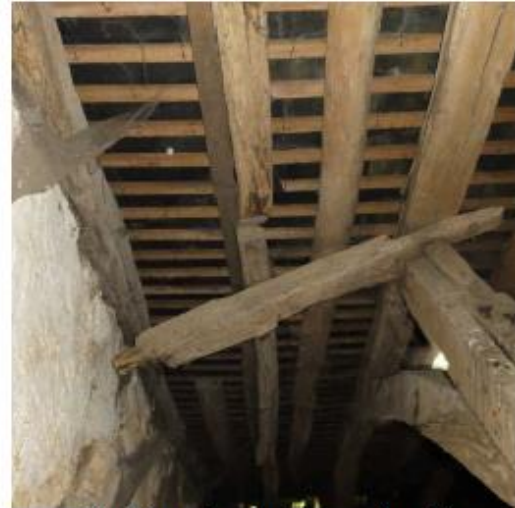
Réparation soutenant les chevrons, décrochée
