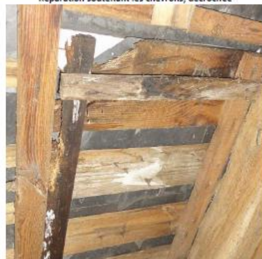
Infiltration d'eau dégradant les liteaux
