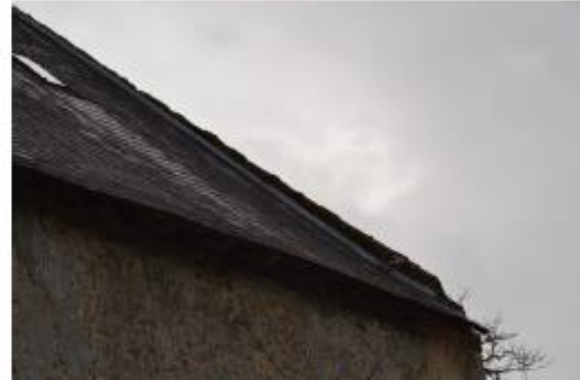
Solin en zinc dégradé
