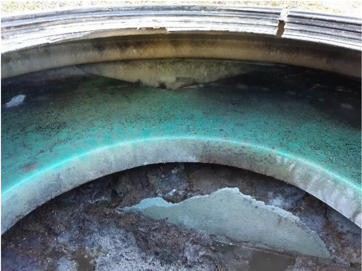
Visite du 8 décembre 2020 : casse d'éléments en résine à l'intérieur du décanteur-digesteur (fixations du cône de sédimentation) et important phénomène de flaquage sur le filtre à sable, avec débordement sur le casier voisin.
