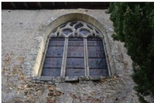
Appui de baie détérioré du grand vitrail en façade sud
