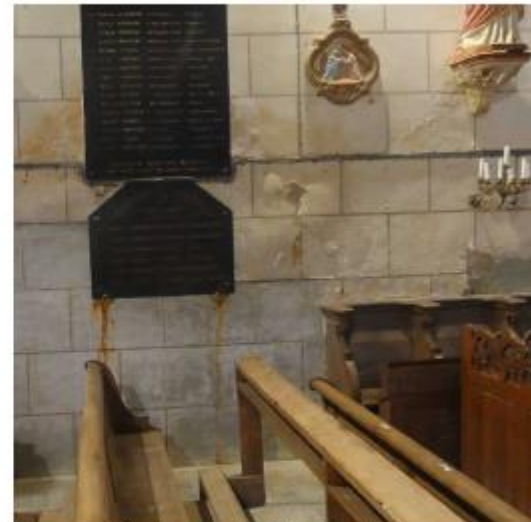
Décollements d'enduits en partie basse
