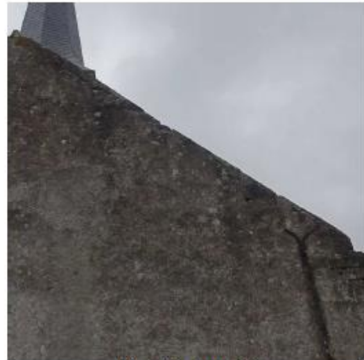
Dégradation du rondelis
