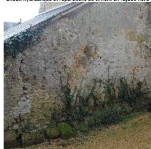
Fissure et lierre en façade nord du chevet
