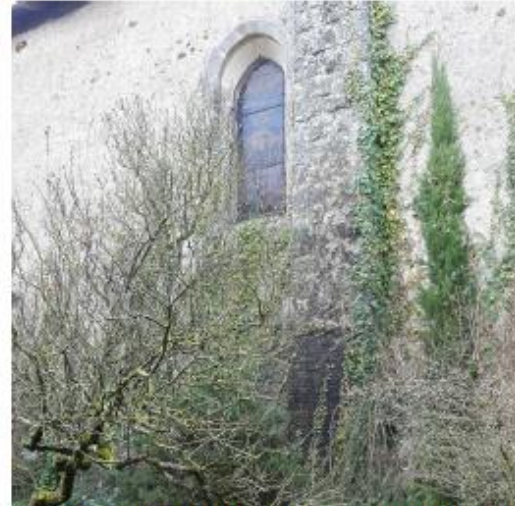
Végétation entraînant une humidité permanente en façade sud
