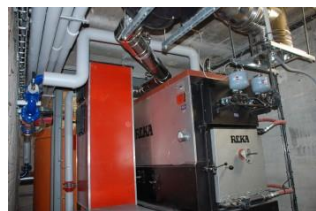
Chaufferie à bois du réseau de chaleur de Montdidier
