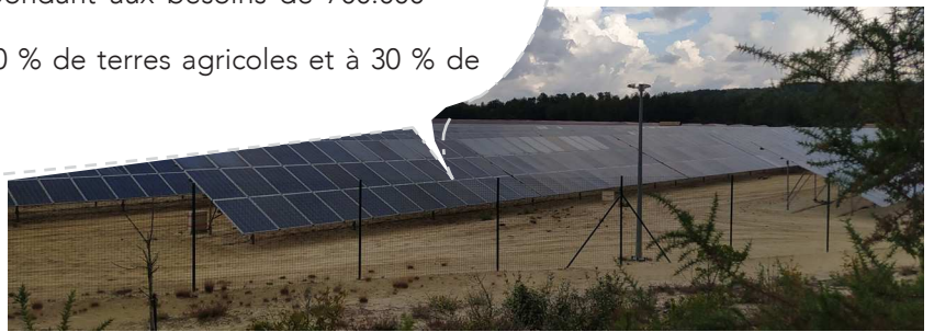
Parc photovoltaïque de Casteljaloux
