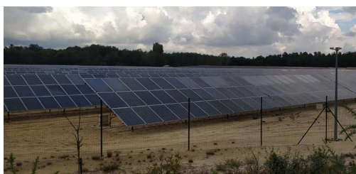
Parc photovoltaïque de Casteljaloux
