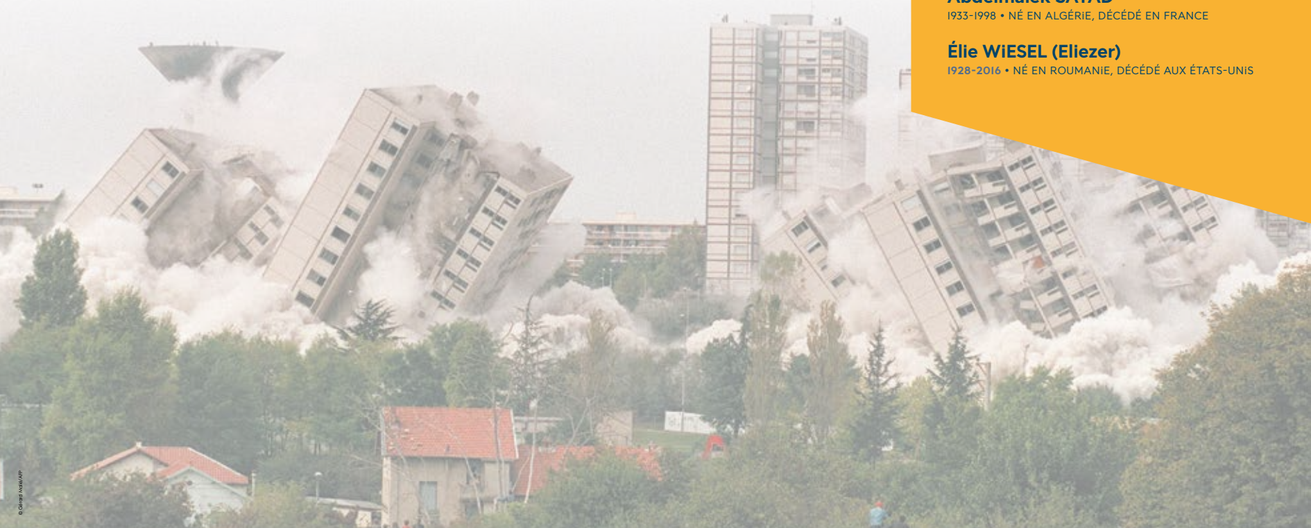
Destruction de 4 tours HLM du quartier Démocratie sur le plateau des Minguettes [Vénissieux], photographie de Gérard Malié, 1994.
