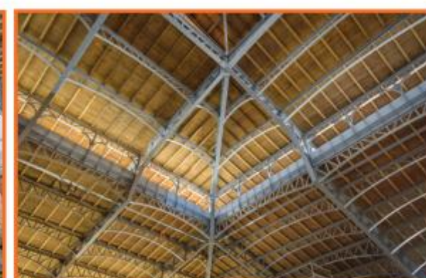
Mise en peinture de la charpente métallique intérieure © Ville de Limoges - Thierry Laporte
